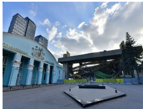
Рисунок 2 – Обрушение кровли здания катка ЦСКА в г. Москве
