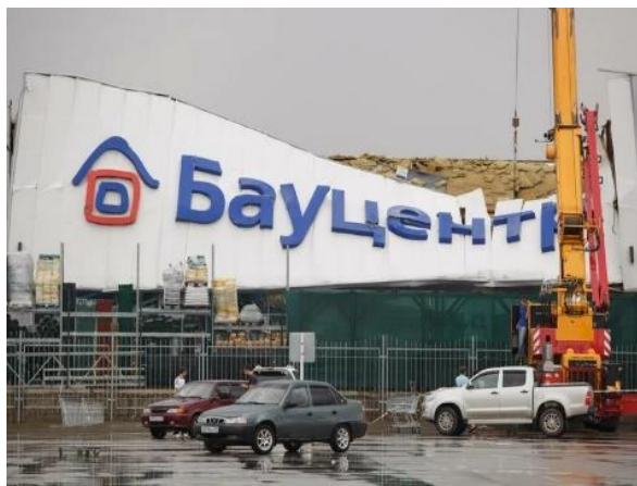
Рисунок 3 – Обрушение крыши «Бауцентра» в г. Краснодаре
