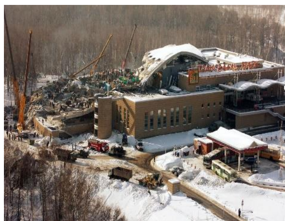
Рисунок 4 – обрушение крыши аквапарка в г. Москве
