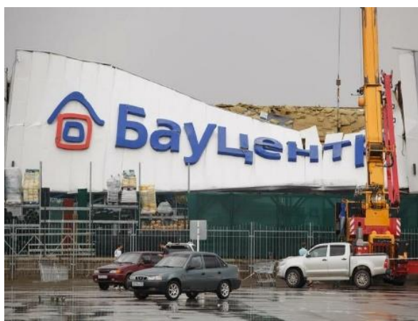
Рисунок 3 – Обрушение крыши «Бауцентра» в г. Краснодаре
